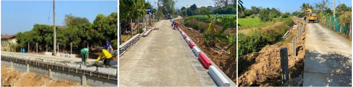
โครงการก่อสร้างถนนแอสฟัลท์ติกคอนกรีต รอบสนามกีฬาประจำตำบลแม่แฝกใหม่
